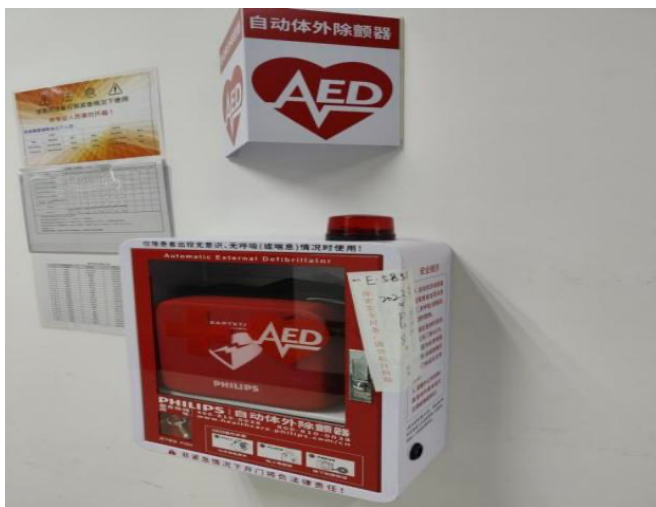
除顫器（AED）安裝
